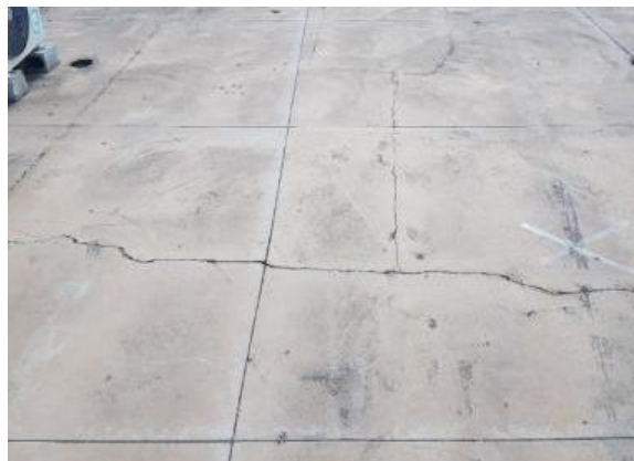
Figura 3 – Trincas e fissuras ao longo das placas.
