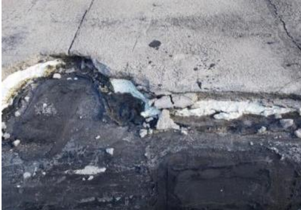
Figura 4 – Degradação da argamassa constituinte da proteção mecânica.
