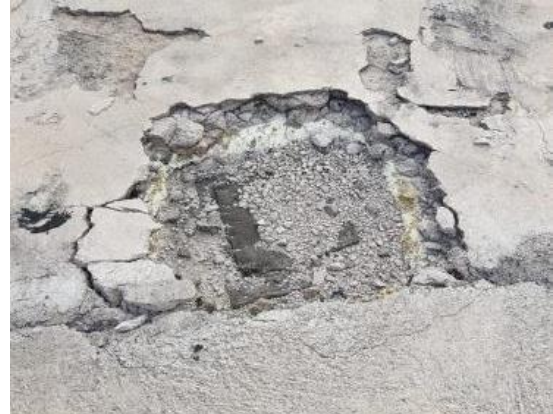
Figura 5 – Esfarelamento da argamassa constituinte da proteção mecânica.
