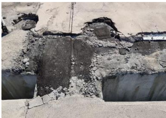
Figura 13 – Juntas de dilatação com fissuras à sua volta e acabamento insatisfatório
