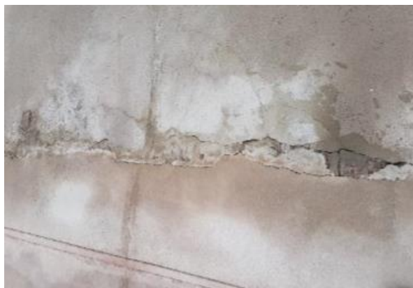
Figura 14 – Junta de concretagem com falha na aderência
