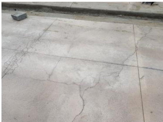
Figura 2 – Trincas e fissuras generalizadas.
