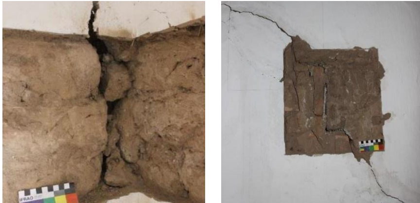
Figura 4 a e b – Exemplos de danos estruturais em paredes e arcos
