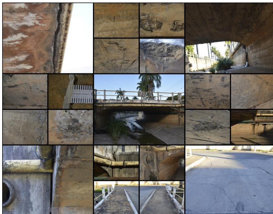
Figura 4 – Manifestações patológicas encontradas na ponte da ponte na Av. Dr. Renato Azeredo, na altura do número 2319, que liga a rua Maestro Paizinho a Av. Dr. Renato Azeredo
