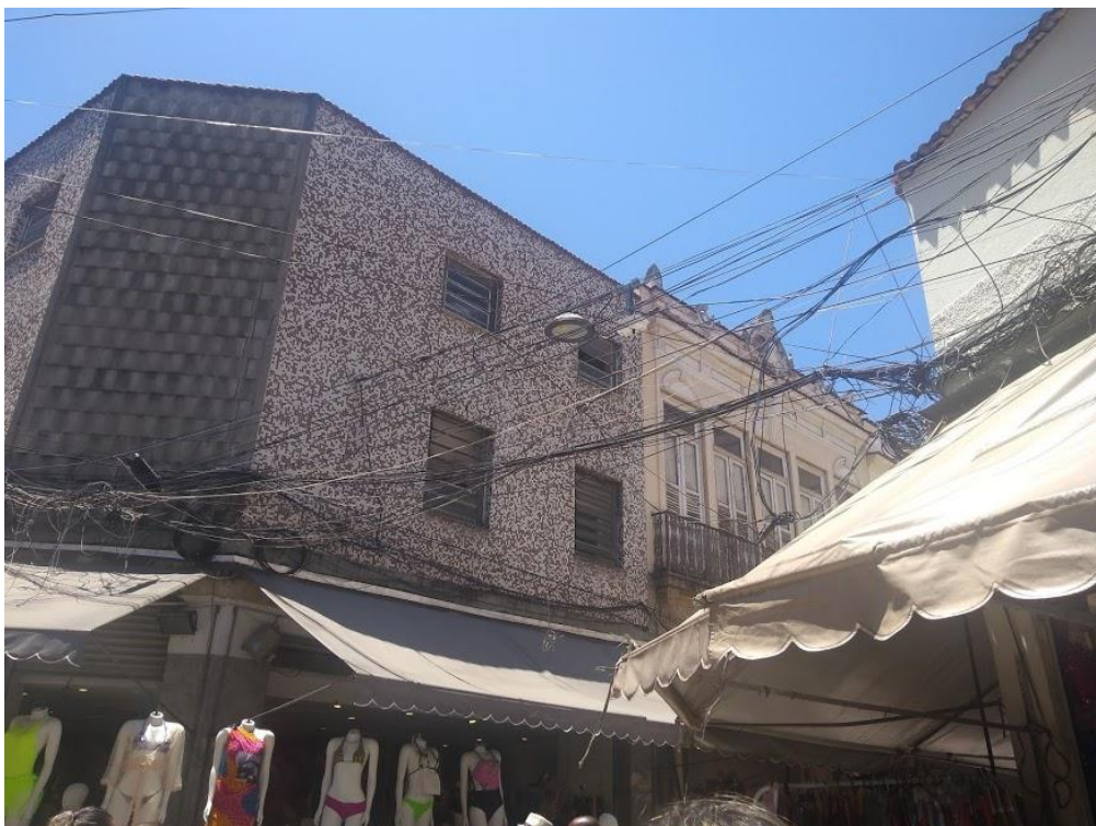
Figura 3 – Instalações elétricas em uma das esquinas do Saara
