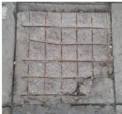
Figura 1 – Placa de concreto com armadura exposta e enferrujada.
