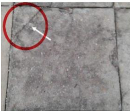
Figura 2 – Rompimento das placas por momento volvente.
