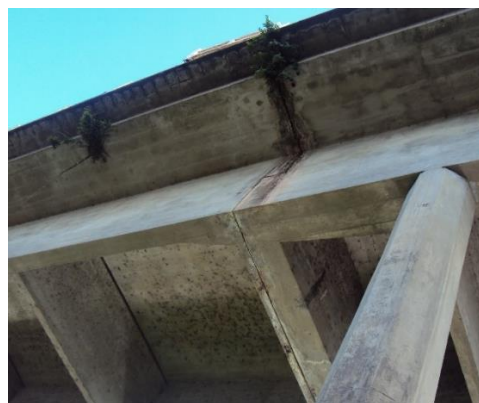
Figura 10 – Manchas de corrosão das armaduras, eflorescências e corrosão das armaduras em vigas e laje em balanço
