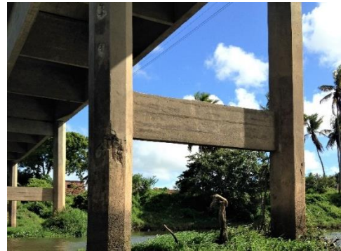
Figura 12 – Pilar com armaduras em processo de corrosão, deslocamento e desagregação do concreto. Manchas de corrosão nas vigas de travamento
