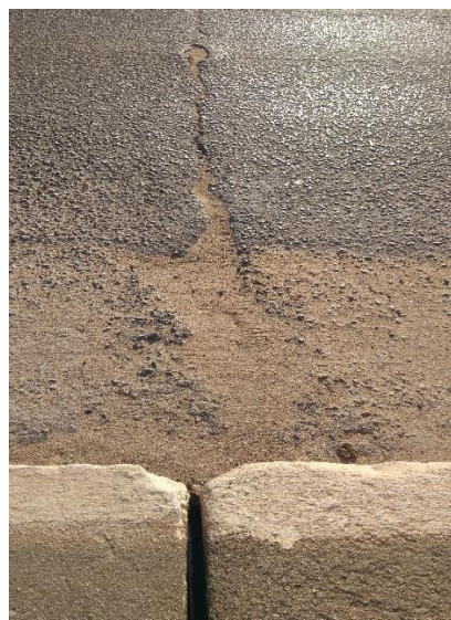
Figura 6 – Danos na pavimentação e aberturas nas juntas de dilatação
