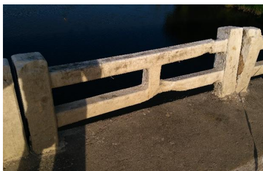
Figura 4 – Guarda-corpo desalinhado e com concreto danificado
