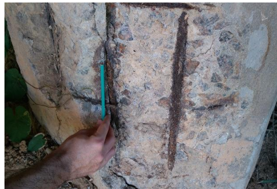
Figura 14 – Detalhe do estado de corrosão das armaduras de um dos pilares da Figura 13
