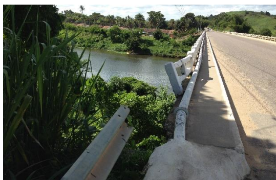
Figura 3 – Desalinhamento e inexistência de guarda-corpo
