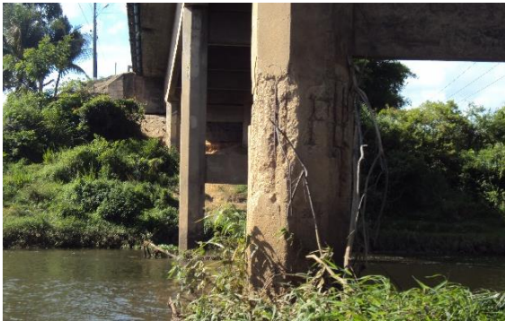
Figura 11 – Pilar localizado no leito do rio em estado avançado de corrosão de armaduras, decorrendo em deslocamento do concreto
