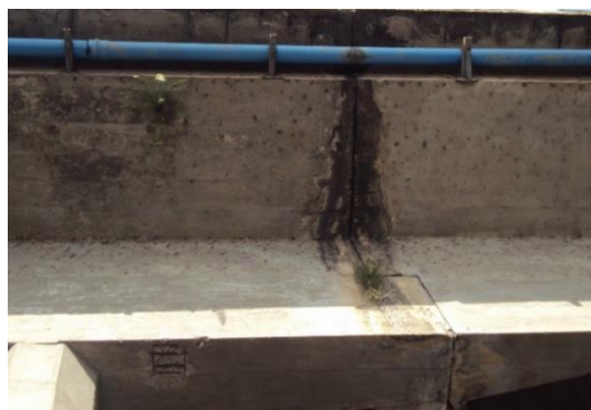
Figura 8 – Infiltrações favorecendo o desenvolvimento de vegetações, eflorescências e corrosão das armaduras em longarinas e laje em balanço
