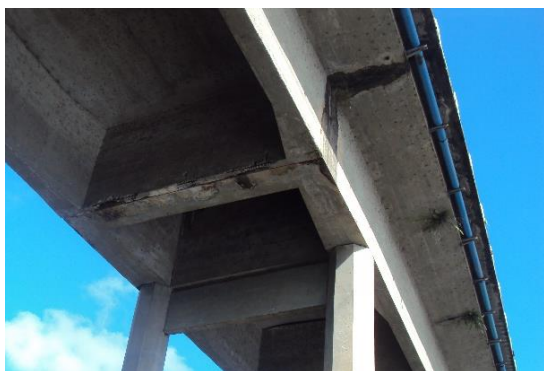
Figura 7 – Infiltrações através das juntas favorecendo a corrosão das armaduras e o surgimento de eflorescências em articulação Gerber
