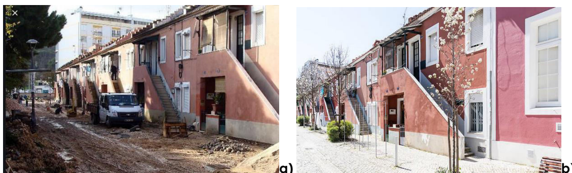
Figura 9 –Vila Grandella / Rua Central: a) lado poente durante a intervenção; b) lado poente após a intervenção
