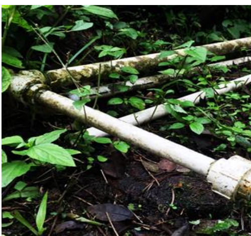
Figura 4 – Encanamento exposto ao tempo, solicitações mecânicas e angulações inapropriadas
