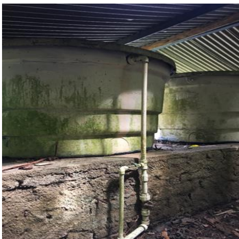
Figura 3 – Caixa d'água com presença de lodo
