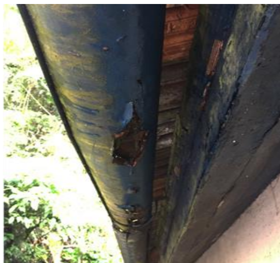
Figura 8 – Anomalias na calha de captação de águas pluviais
