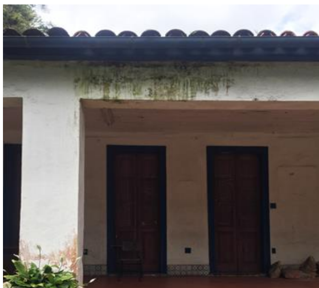
Figura 7 – Infiltração presente na fachada da edificação
