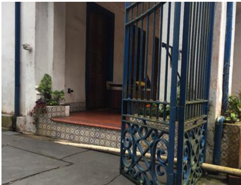
Figura 6 – Tubulação de esgoto improvisado exposto a intempéries
