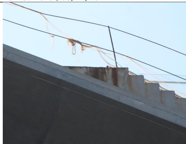
Oxidação na estrutura das escadas Fonte: Autor, 08/12/2019
