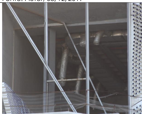
Infraestruturas internas expostas aos agentes externos. Fonte: Autor, 08/12/2019
