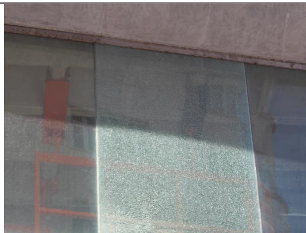
Vidro quebrado na fachada sul Fonte: Autor, 08/12/2019
