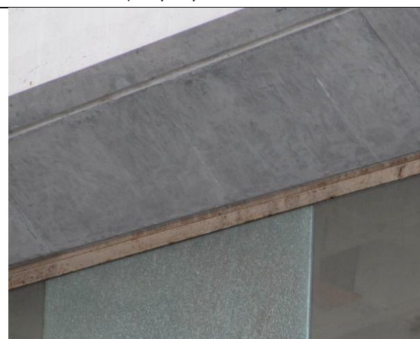
Oxidação dos perfis das esquadrias Fonte: Autor, 08/12/2019
