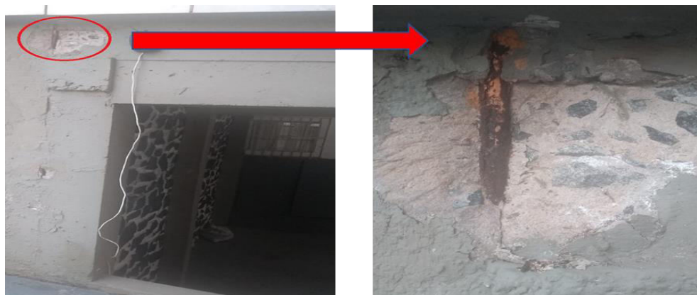
Figura 3 – Corrosão do aço no Pilar 1
