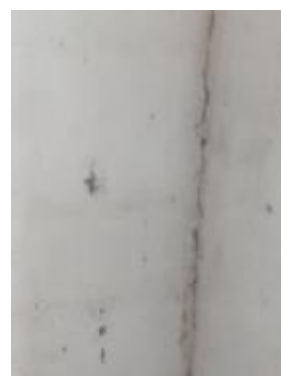
Figura 9 – Rachaduras nos cunhais
