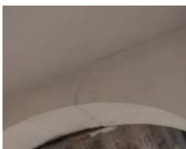
Figura 3 – Foto das fissuras nos arcos
