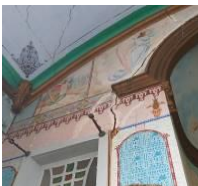
Figura 8 – Fendas na parede do altar-mor
