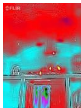
Figura 18 – Termograma da parede.
