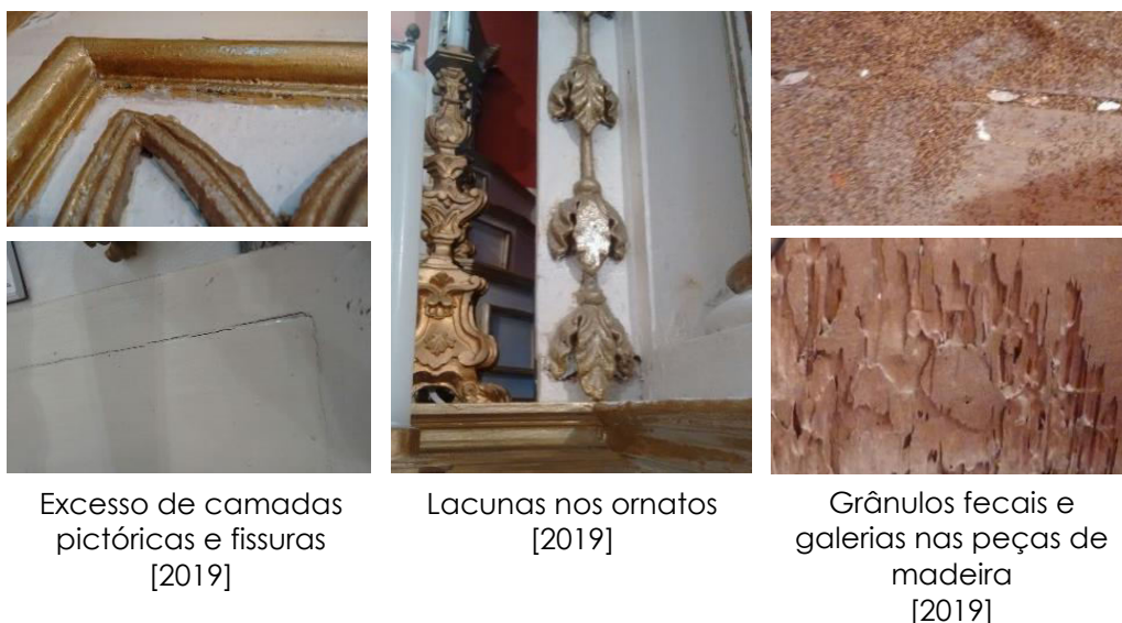
Figura 5 – Demonstração das patologias encontradas na madeira
