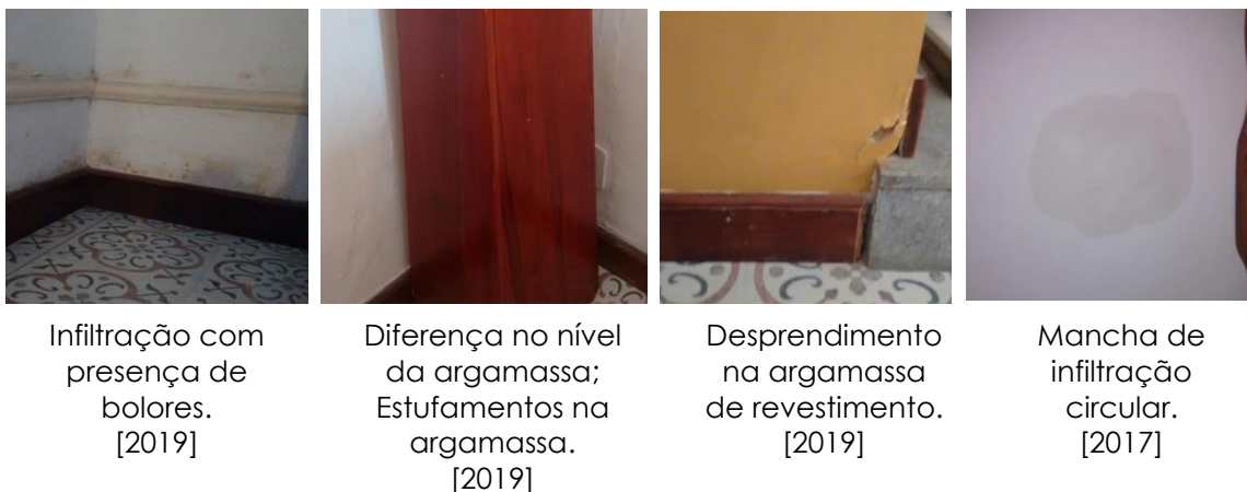
Figura 4 – Demonstração das patologias encontradas nas alvenarias
