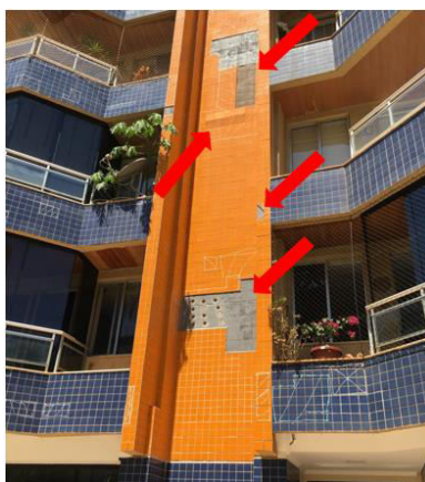
Figura 3 – Destacamento e estufamento do revestimento cerâmico (Fachada A)
