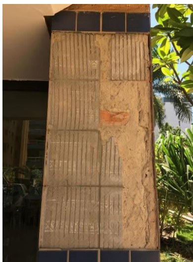
Figura 5 – Sem revestimento cerâmico e parcialmente coberto de argamassa (Fachada C)
