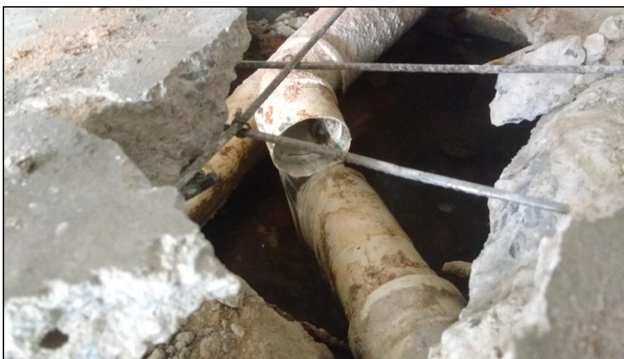
Figura 4- Evidência de escoamento de água servida
