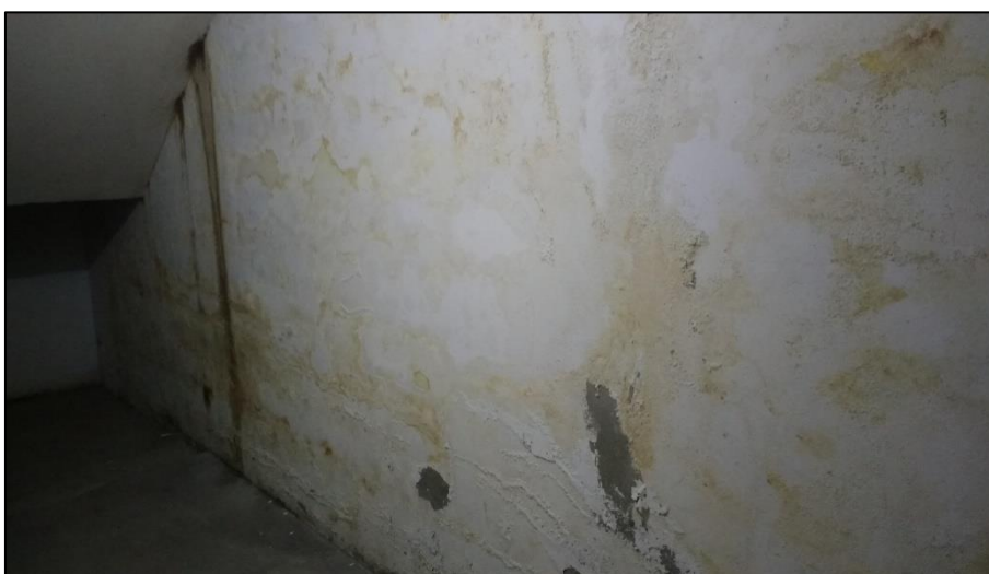
Figura 5 – Muro de arrimo com infiltração no pavimento inferior (subsolo)
