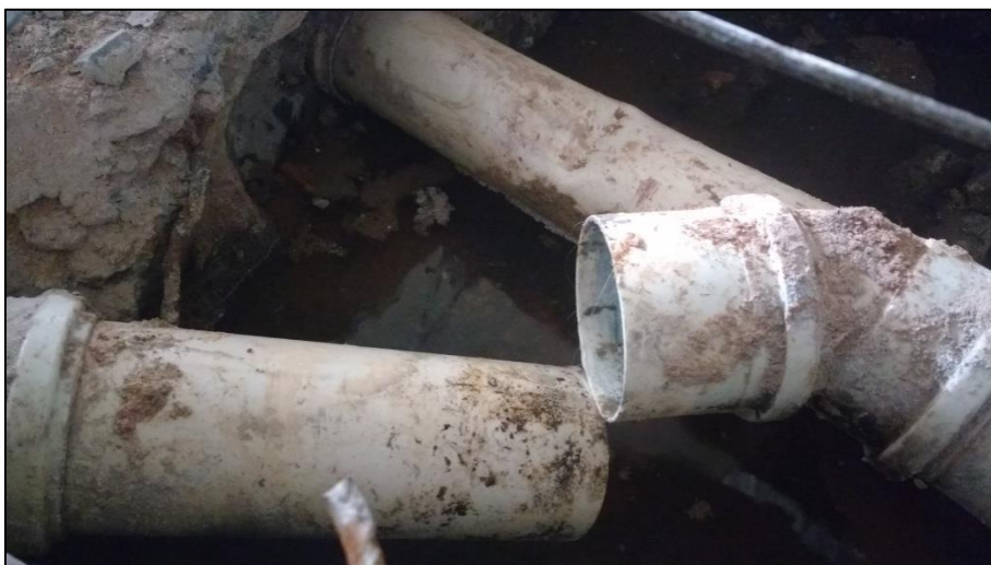
Figura 3 – Esmagamento e deslocamento da tubulação
