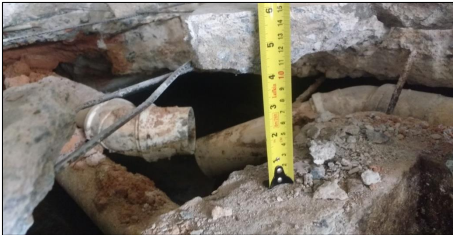
Figura 2 – Recalque da caixa de gordura (10 cm)
