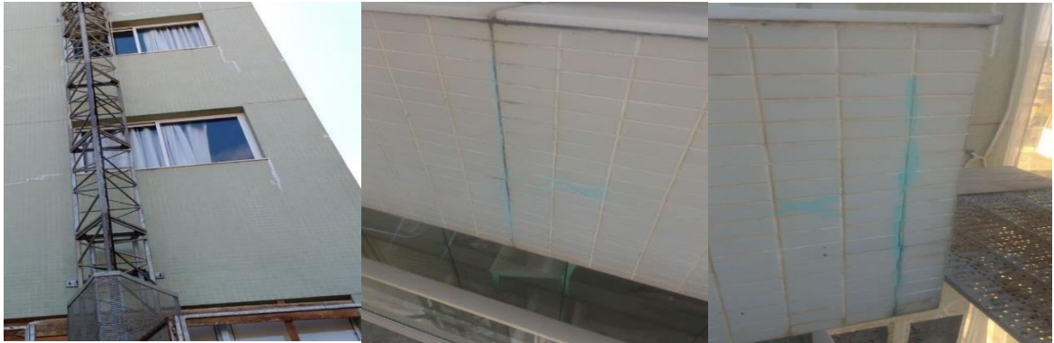
Figura 3 – Fissuras verticais próximas às janelas
