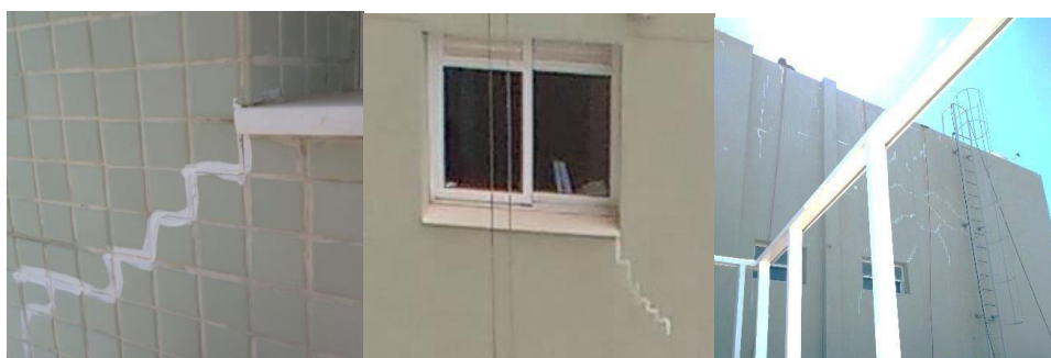
Figura 2 – Fissuras inclinadas na quina da janela e no ático
