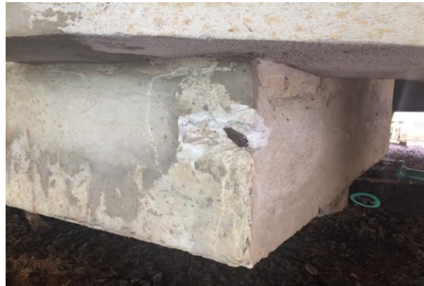
Figura 7 - Disgregação do concreto e armadura corroída
