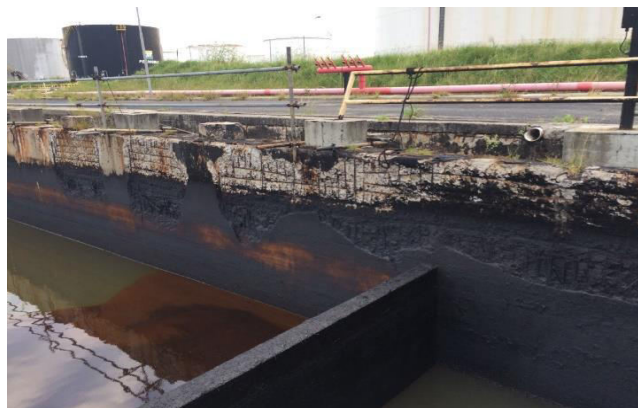
Figura 8 - Patologias nas paredes da BAC 2
