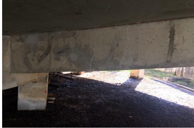
Figura 6 - Fissuração nas vigas do Flotador
