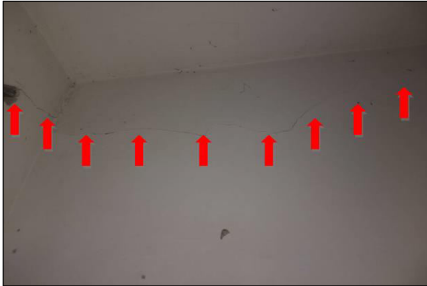
Figura 7 – Fissura horizontal na parede da cozinha
