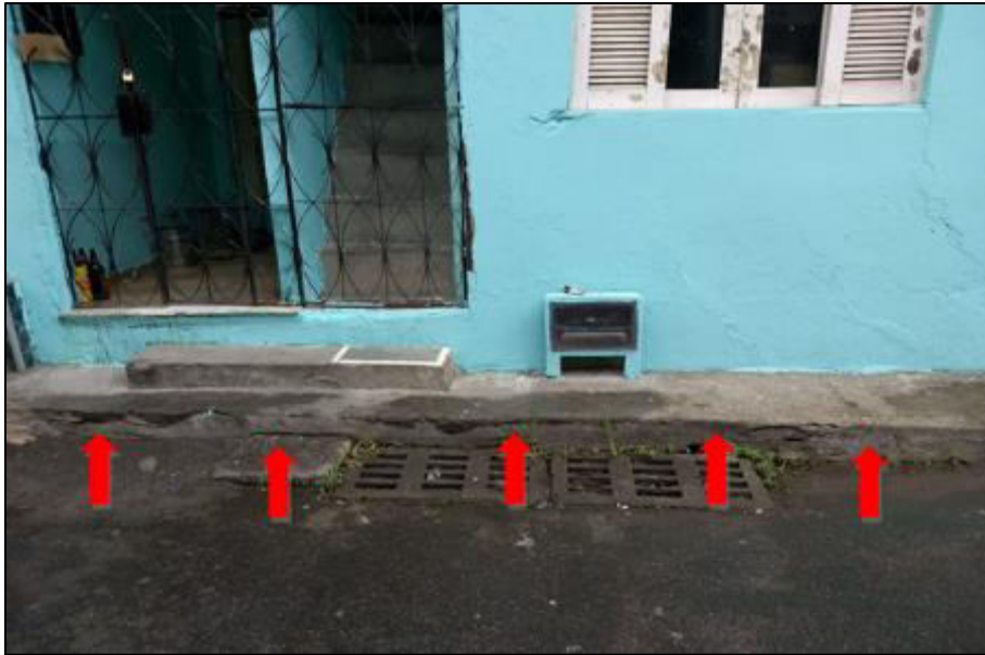
Figura 3 – Trinca no passeio da fachada do imóvel
