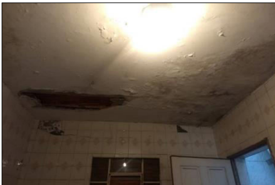
Figura 15 – Infiltração e deslocamento na laje da cozinha
