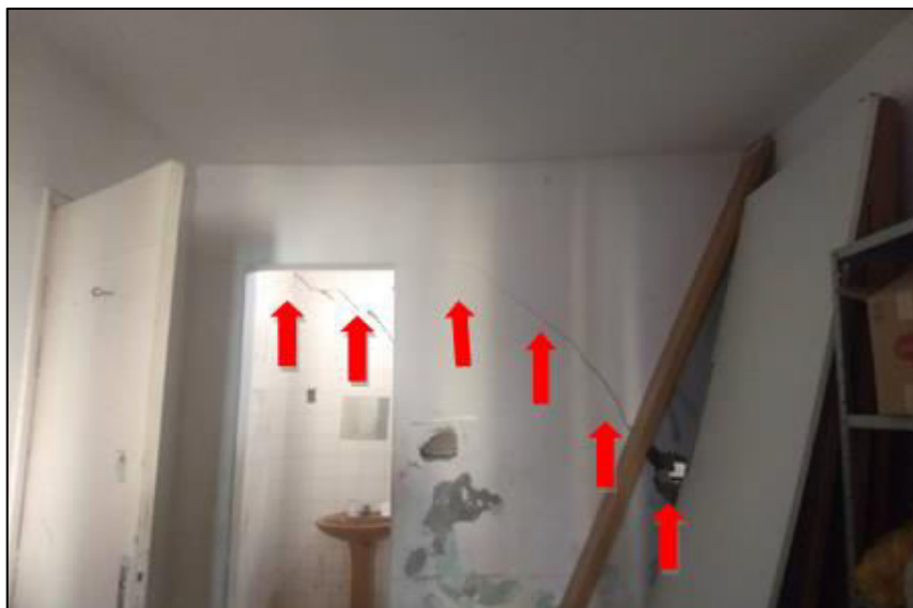
Figura 10 – Fissuras inclinadas na parede do quarto
