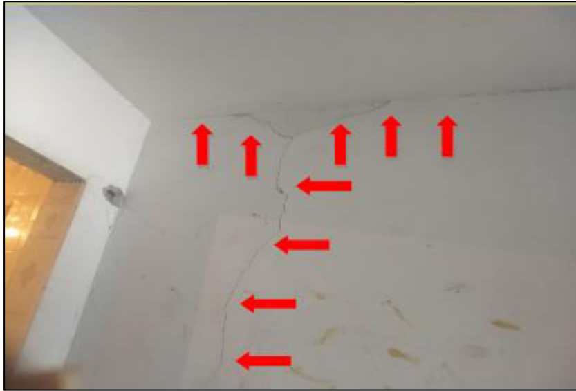
Figura 9 – Trinca vertical na parede da sala
