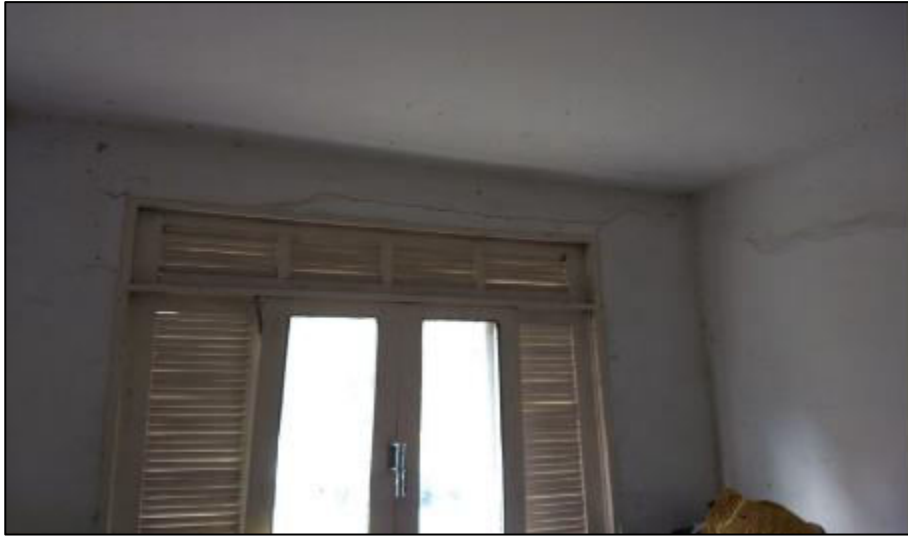
Figura 5 – Fissura horizontal no ambiente interior
