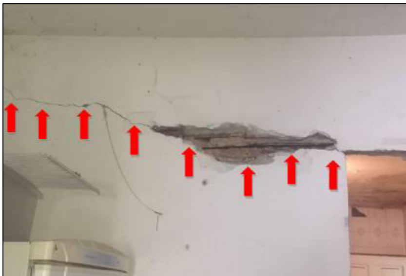
Figura 8 – Fissura na cozinha com deslocamento do revestimento
