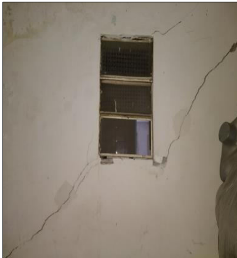
Figura 12 – Rachadura inclinada na parede do banheiro
