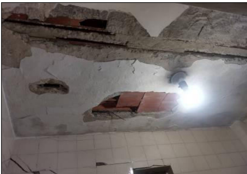
Figura 14 – Deslocamento e corrosão na laje do banheiro
