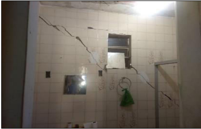
Figura 11 – Rachadura inclinada a aproximadamente 45° no banheiro
