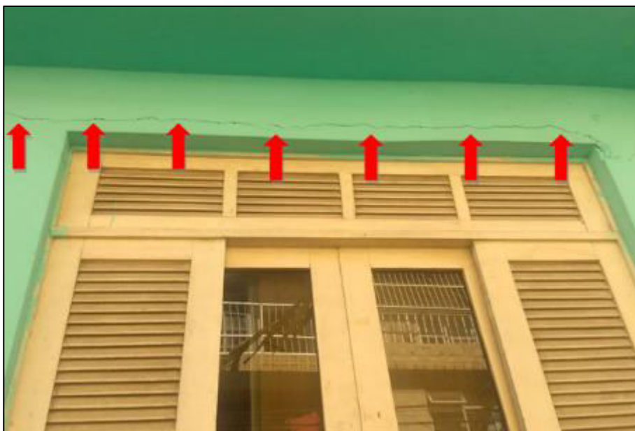
Figura 4 – Fissura horizontal na fachada
