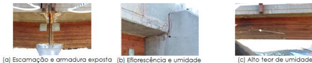
Figura 5 – Identificação de danos na ponte de Keystone (Dakota do Sul)
