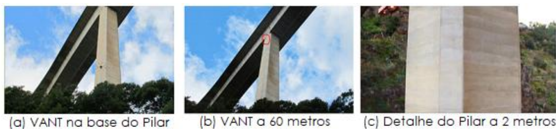
Figura 4 – Detalhe das manifestações patológicas na Ponte João Gomes, ilha da Madeira.
